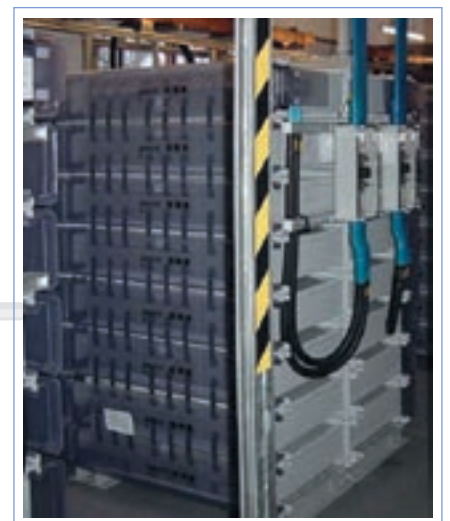
Рис. 9 Аккумуляторы Absolyte – установка в системе бесперебойного питания
