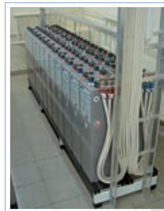
Рис. 18 Смонтированная батарея A600 OPzV
