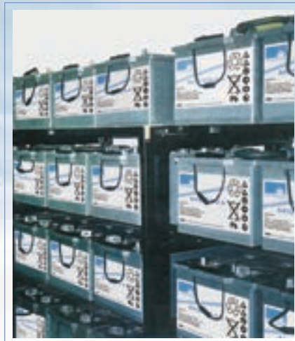
Рис. 14 Смонтированная батарея A400
