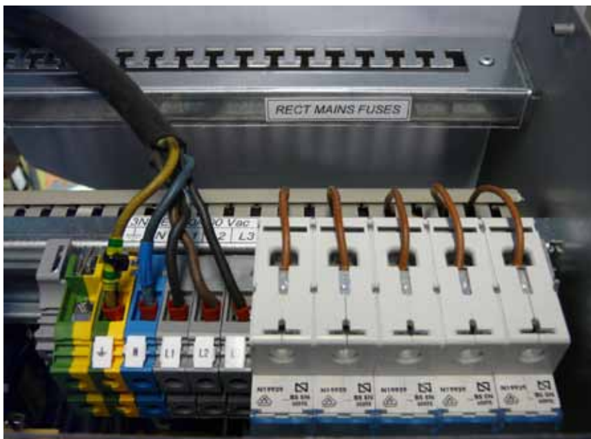
Рисунок 4 Клеммы подключения системы OPUS в корпусе 19" к сети электроснабжения и автоматы на входе выпрямителей.
